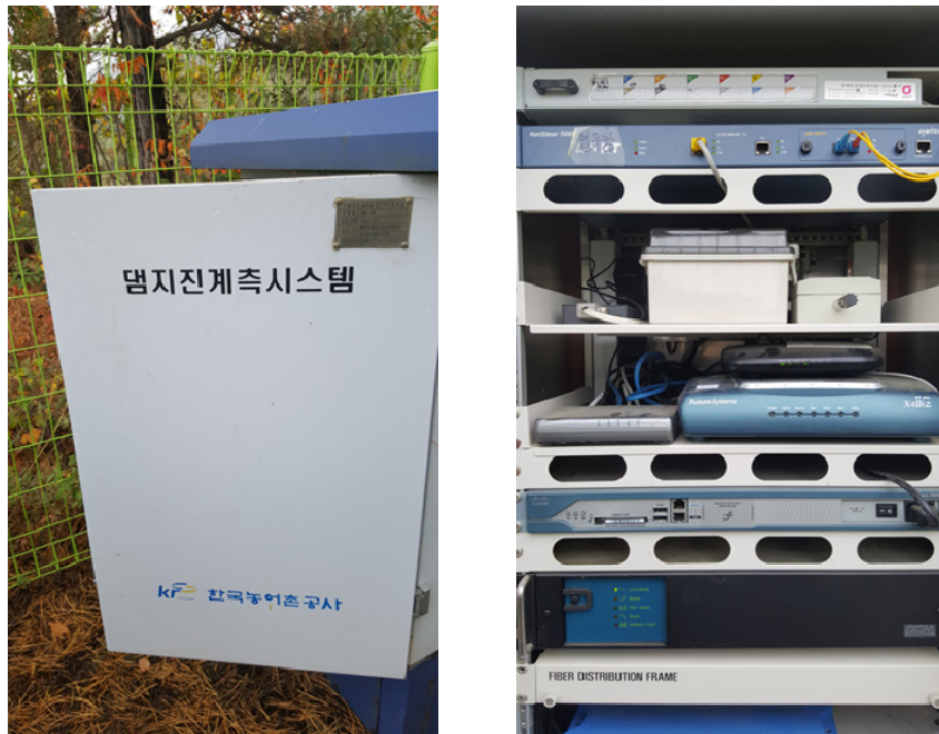
<그림 4-12>이동저수지 댐진진 계측기 설치 현황
