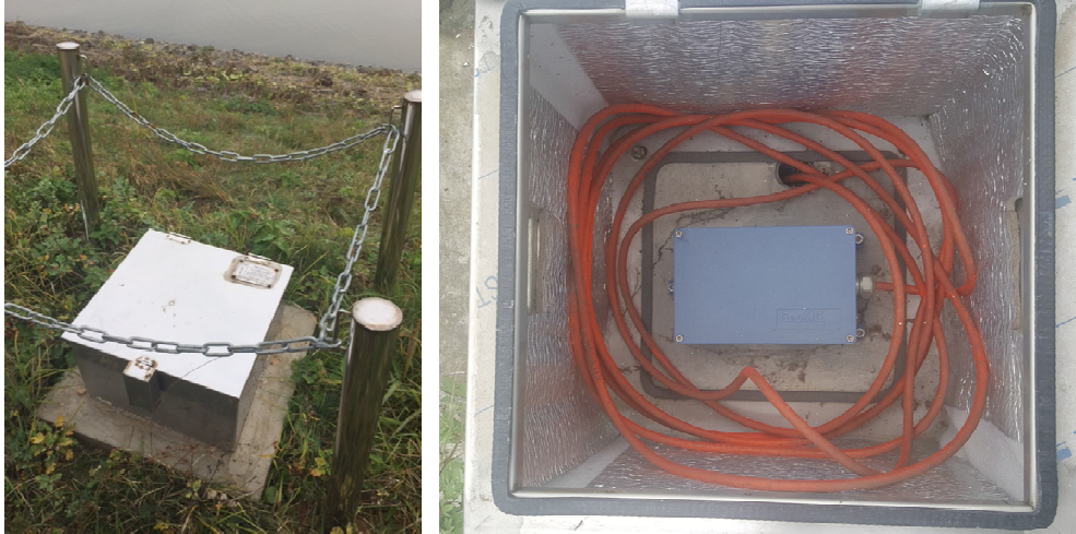
<그림 4-11>이동저수지 지하수위 측정기 설치 현황
