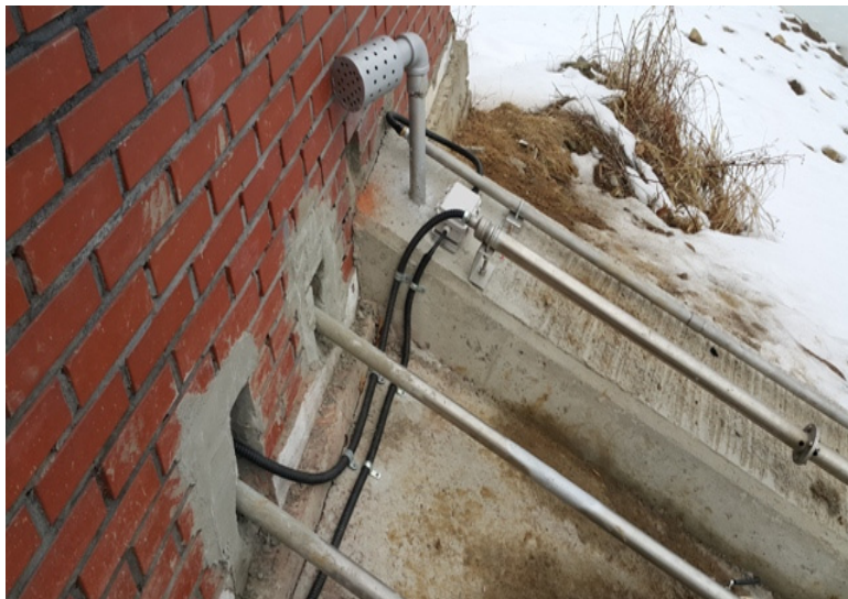
<그림 4-10> 수위계 계측센서 설치
