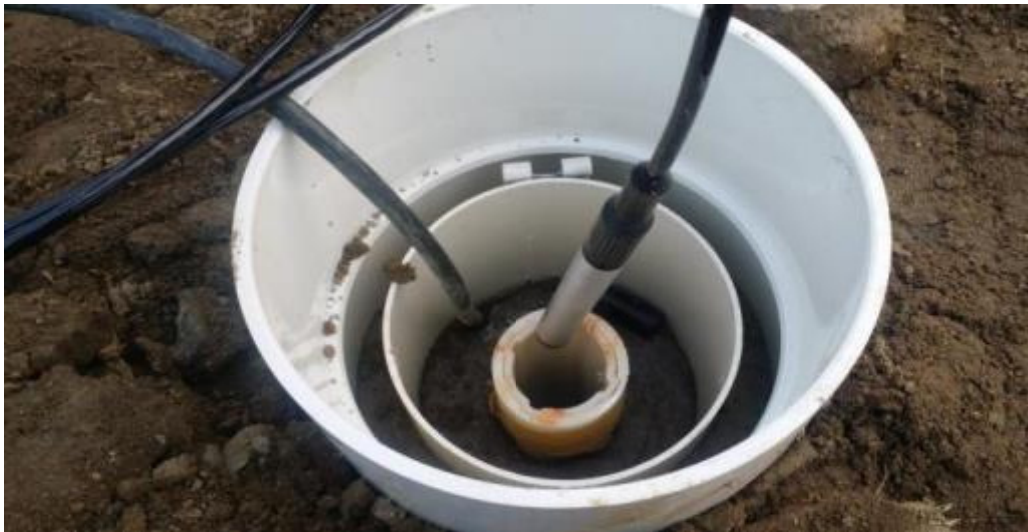
<그림 4-7> 지하수위계 계측센서 설치
