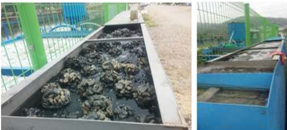
<그림 3-34> 바이오스톤 접촉산화시스템 플랜트 설치 전경
