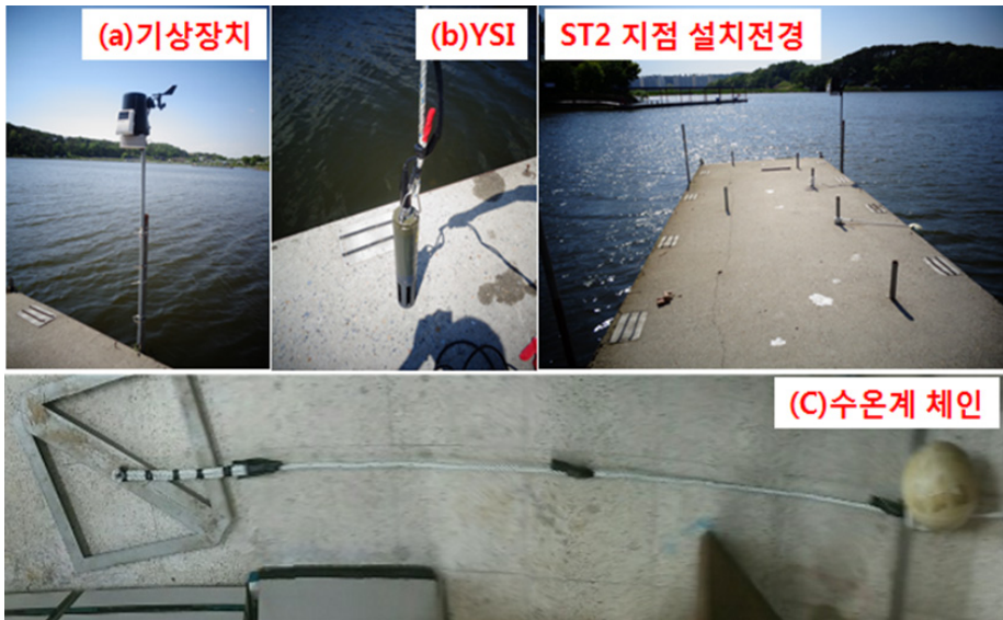
<그림 3.2-3> 매화저수지 연속 모니터링장치 설치 전경
