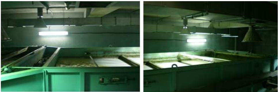
<그림 4.3-9> 인천 소래공원의 가압부상장치(지하)
