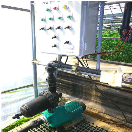
현장시험에 사용된 콘트롤러 및 펌프
