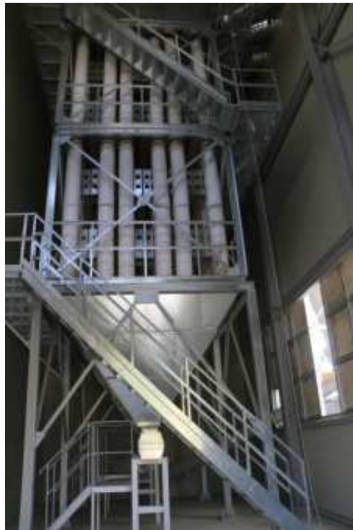
그림 2-2-1-24. 경북 예천소재 RPC에 설치된 실내설치형 통합집진기 모습
