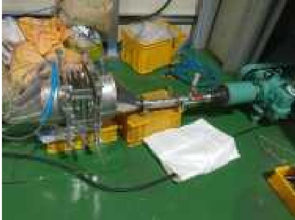
root blower 및 가습장치
