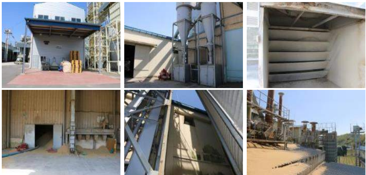
그림 2-2-1-9. 경남소재 RPC의 집진시설 설치 및 운영현황
