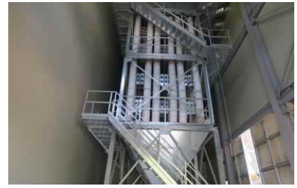
(통합집진기 내부 전경)
