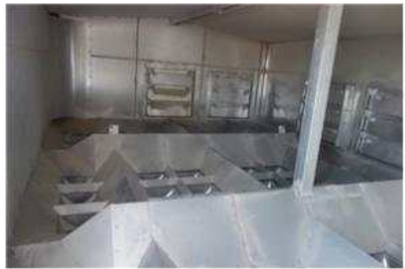
(실제 설치된 공기유입부 및 여과포연결부위)
