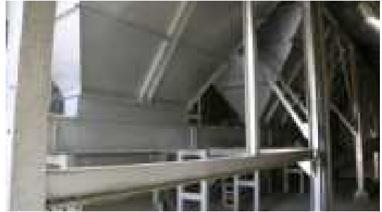
(집진부 하단의 분진 이송 컨베이어)
