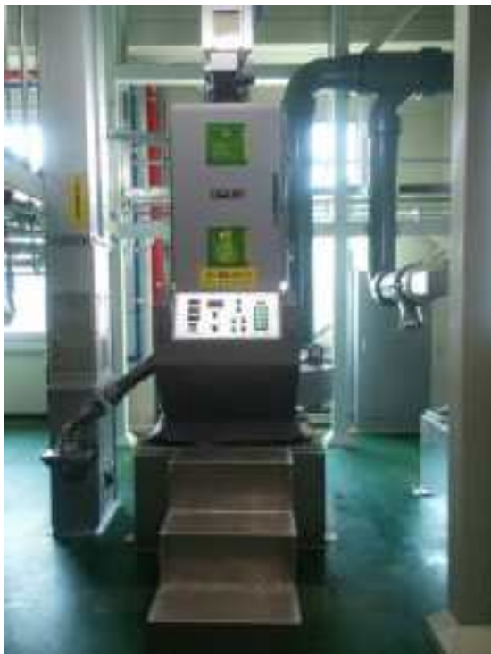
(설치된 연속식 클린라이스 대량제조시스템)
