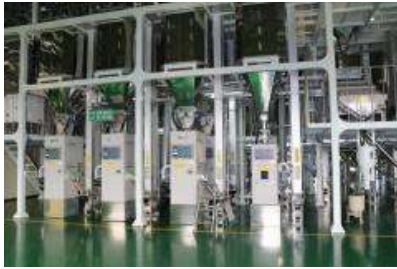
배치타입이 다수 설치
