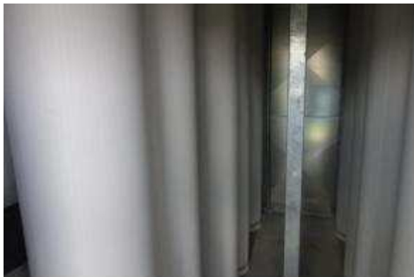
(실제 설치된 여과포)
