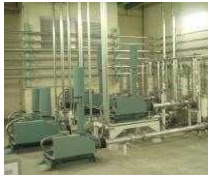
Roots blower 및 온습도조절
