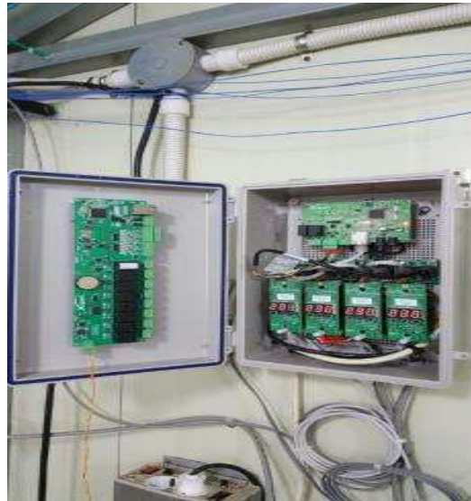
[그림] 모형돈사에 설치된 제어장치 설치
