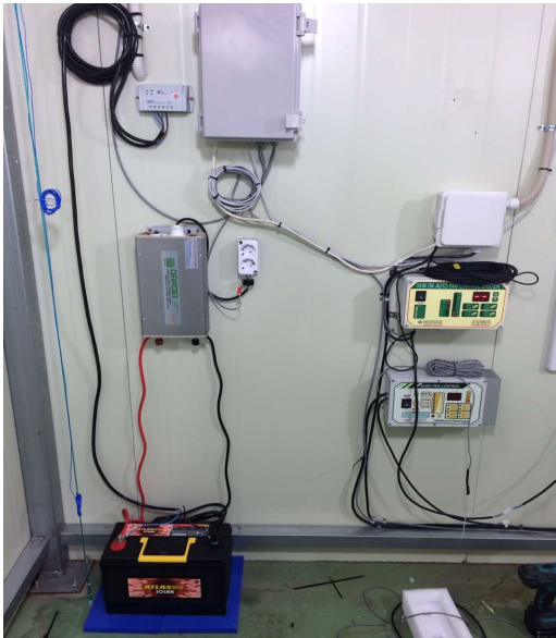
[그림] 12 모형돈사 내 통합 전력량계 설치.
