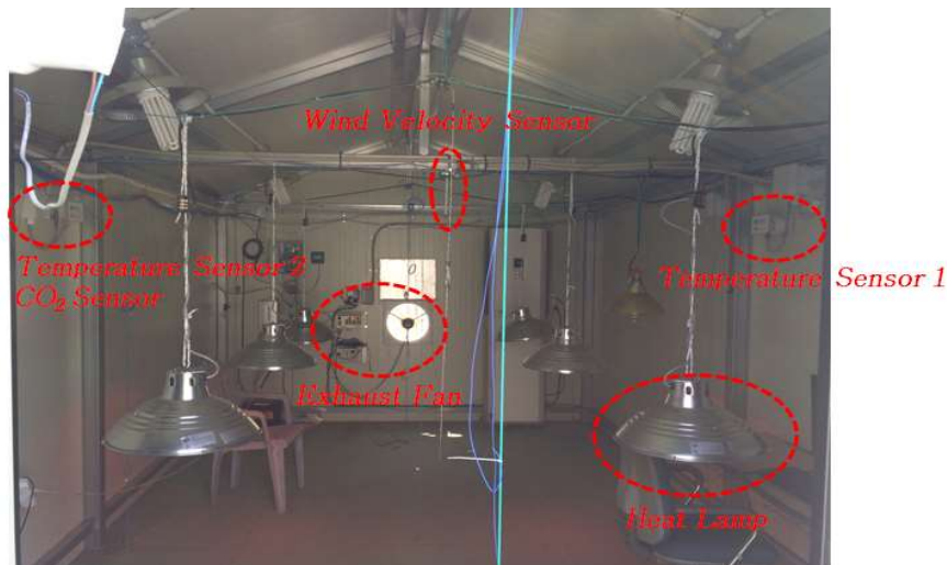
[그림] 9 모형돈사 내 LEMS 설치 및 측정 위치.
