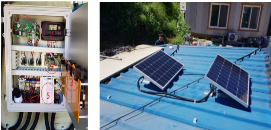
[그림] 주호농장 스마트 전력 측정시스템의 설치와 태양광 패널 설치모습
