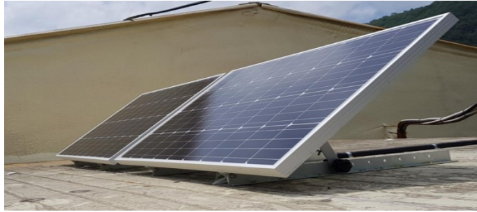
[그림] 태양광 패널 설치 상태
