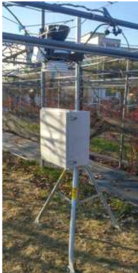
그림160. 데이터수집장치 현장 설치도
