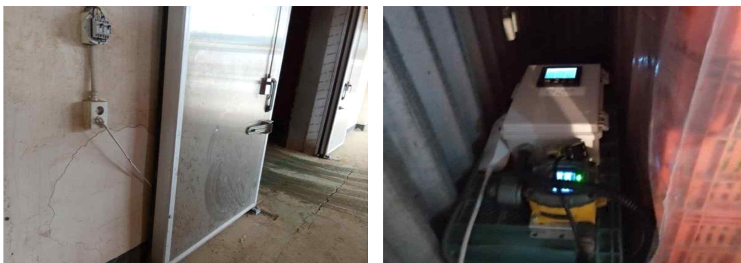
그림 5-15. 저장고 내 전선 코드 설치와 온습도 기록계 및 가스기록계 설치
