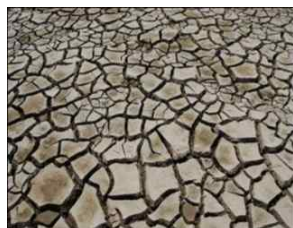
(a) 매립지반에서의 토양 Crack
