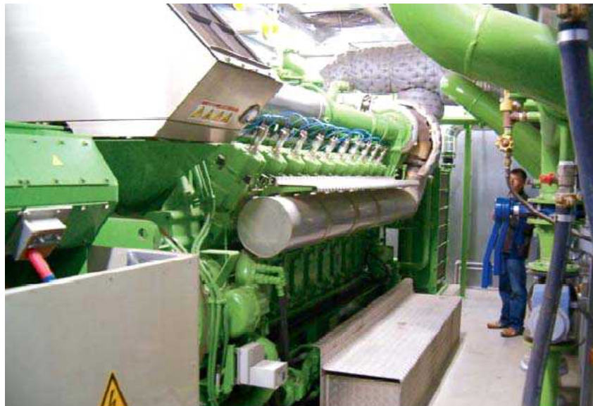
그림 124. 원예시설의 열병합발전실 내부 모습
