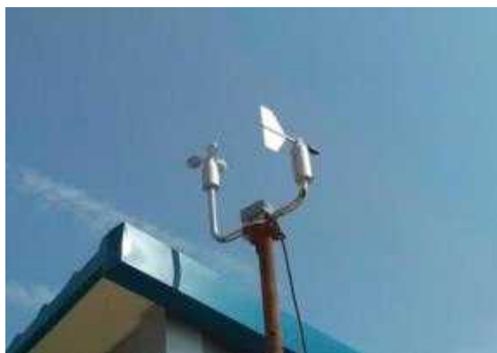
그림 1-47. 풍향·풍속 측정기. 풍향 풍속 측정기는 외부에 설치하여 실시간 대
