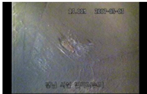
<복통 천정부 균열 및 누수>
