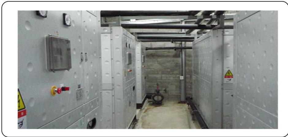
〈그림 8-1〉 양식장에 설치된 히트 펌프
