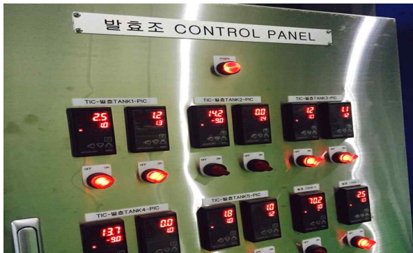
<발효조 온도 control panel>
