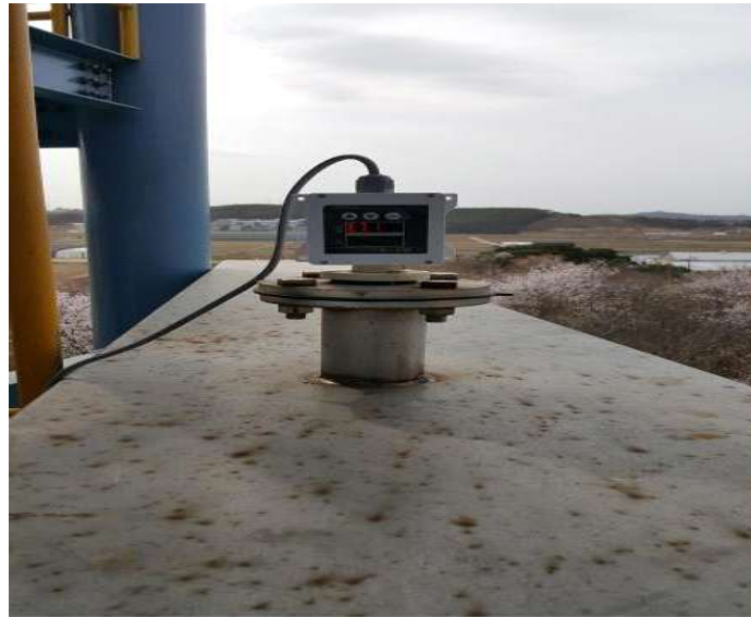
<발효 저장조 내부 온도 측정 및 데이터 수집>
