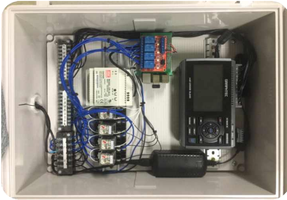
<센서모니터링 컨트롤박스 내부>
