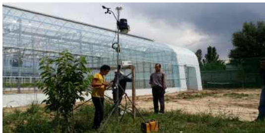
외부 센서 설치
