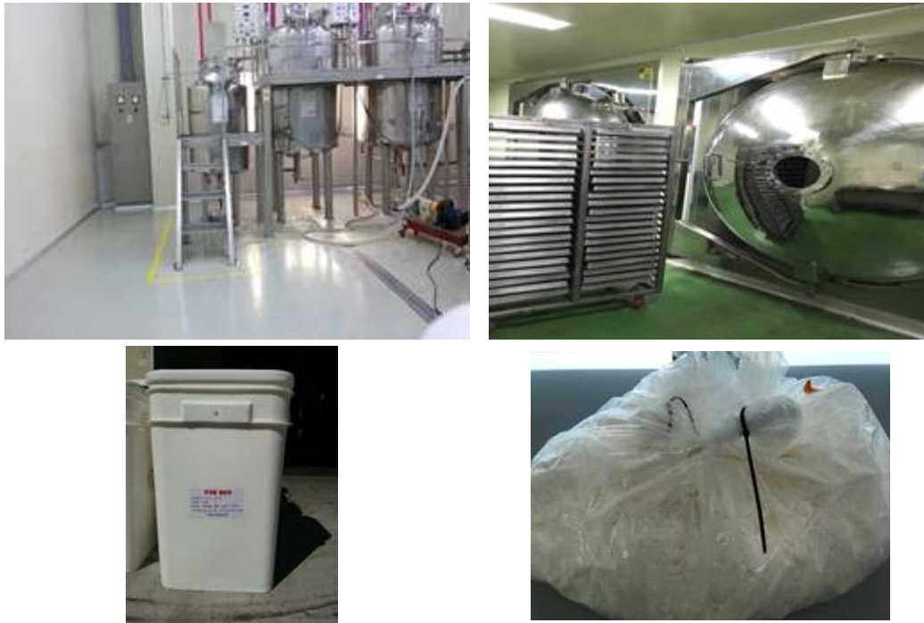
Fig. 51. 신바이오틱스 고농축 발효액 제조 설비 및 제품 - 배양탱크, 동결건조기
