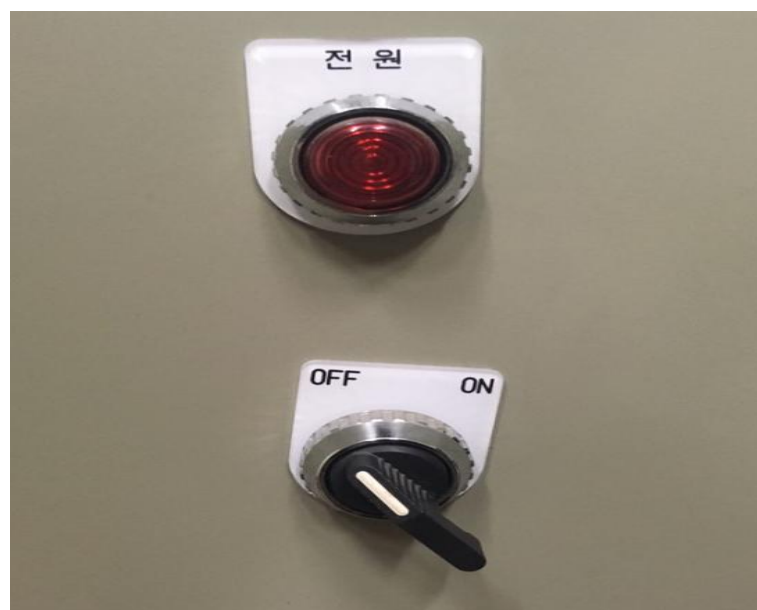
[그림 77] 인버터 전원 공급 단자부
