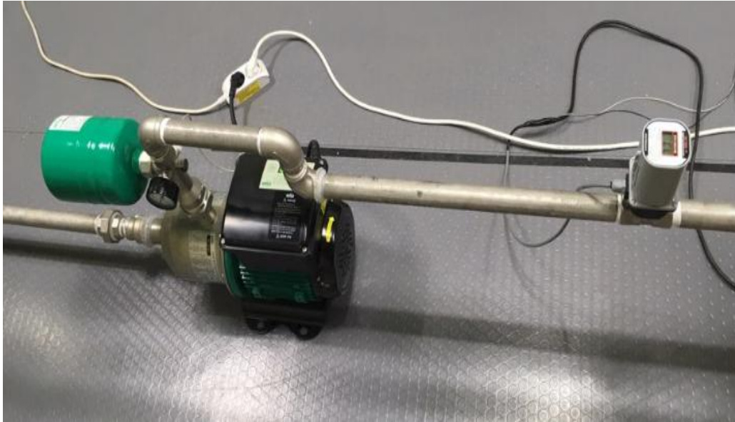
[그림 75] 유량제어 밸브 및 펌프
