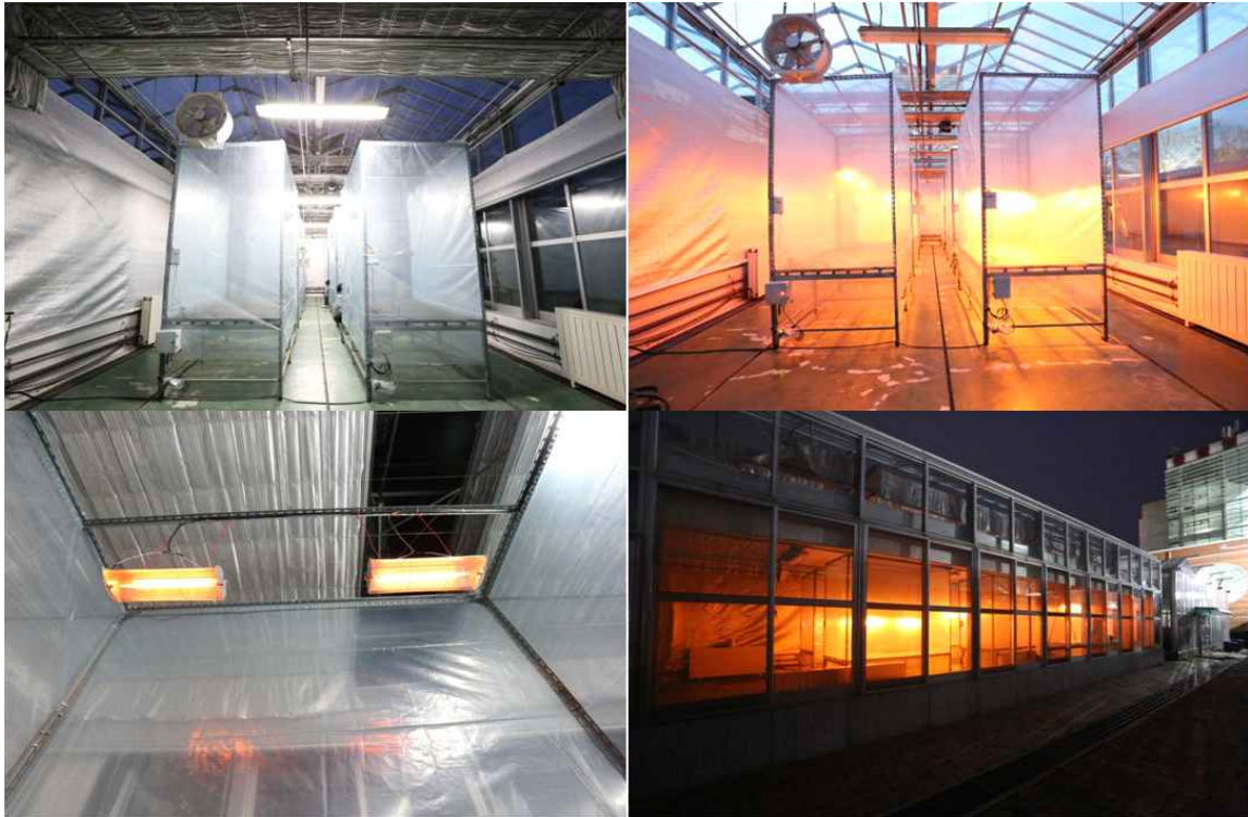
그림 2-75. 유리온실 내부의 나노탄소섬유적외선 난방등(nano-carbon fiber infrared heating lamp)의 설치높이와 전력별 배치 모습.
