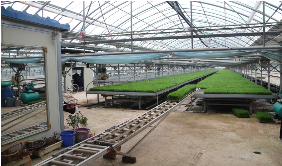
그림 2-29. 자동(벨트방식) 및 수동(롤러방식) 컨베이어 장치를 혼용하여 설치된 모습.
