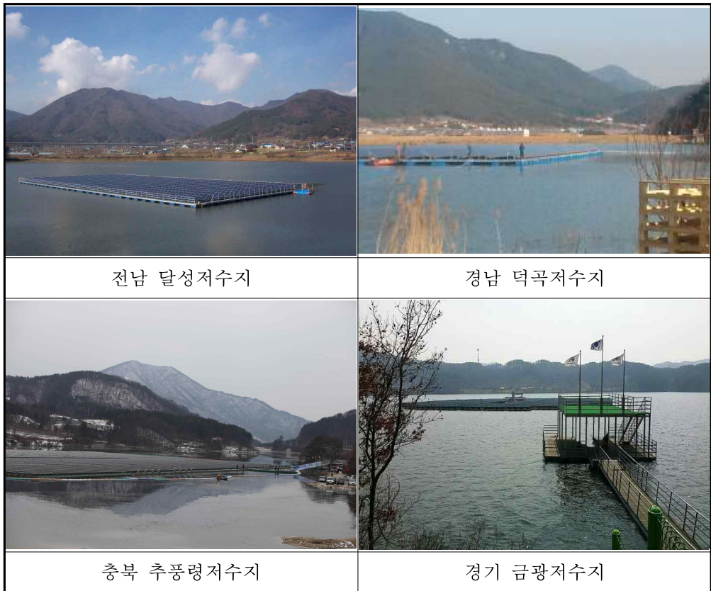
<그림 6-7> 저수지 수상태양광 설치사례
