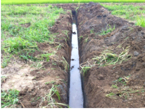
[그림 4.26] 터파기 후 물고임
