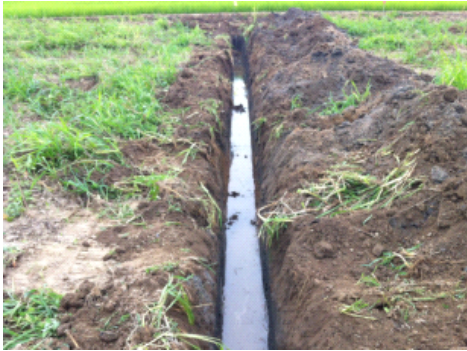
[그림 2.2] 터파기 후 물고임
