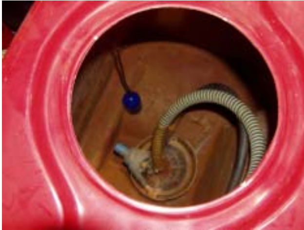
그림 3.4.20 약액탱크내 설치된 수위 센서.
