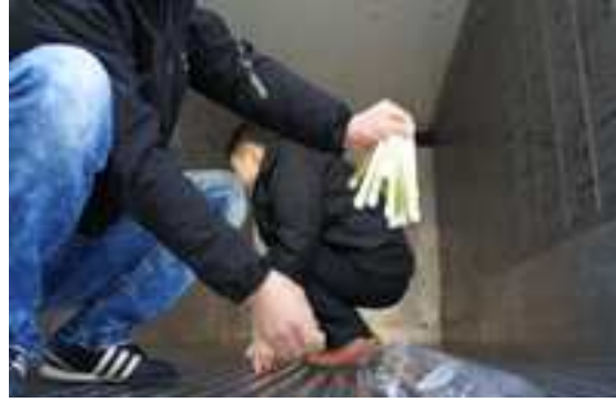
그림 8. 균밀도 재증식 억제용 저농도 지속처리 이산화염소 발생 장치 투입
