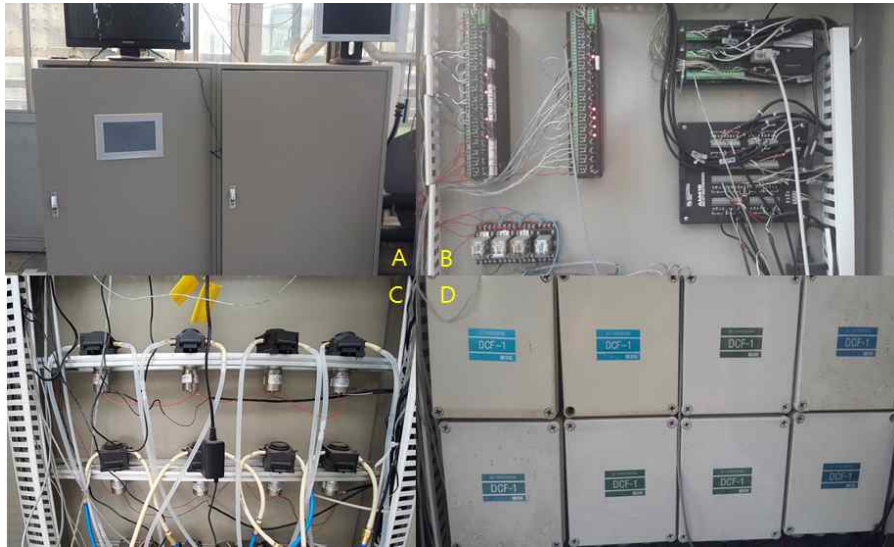
그림 3-5-13. 확장된 유동 혼합 알고리즘 및 관행 재사용 양액 혼합 방식의 구현이 가능한 실증 실험 장치 제어부와 구동부(A: 제어반, B: 제어기, C: 양액 이송용 연동펌프 배열, D: 센서 신호 변환부)
