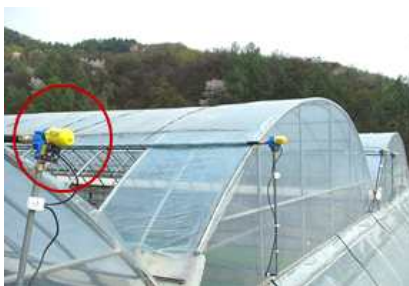
< 천창에 설치된 개폐기 >
