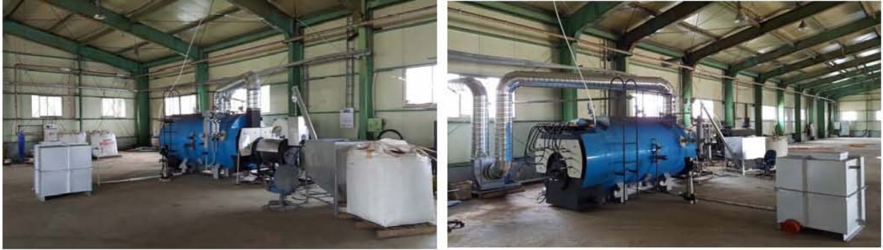
<그림 3.41> 액상연소로 및 폐열보일러 설치 전경
