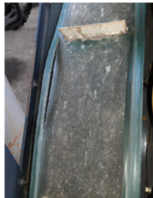
<이송 벨트 파손>
