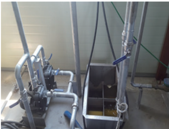
〈유량조정조-〉탈질조 이송펌프, Bypass 배관 및 V-notch(막분리조-〉 탈질조 반송)
