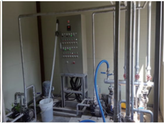
〈통합판넬 및 원수 이동 배관, 반응조 교반감속기 및 브로워 설비 등〉
