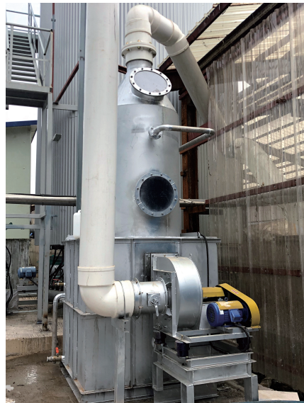
<약취저감설비 설치 전경>
