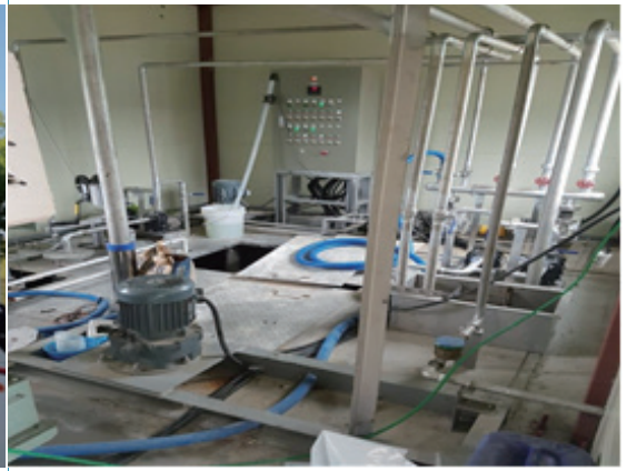
〈착유세척수 처리시설 내부전경〉
