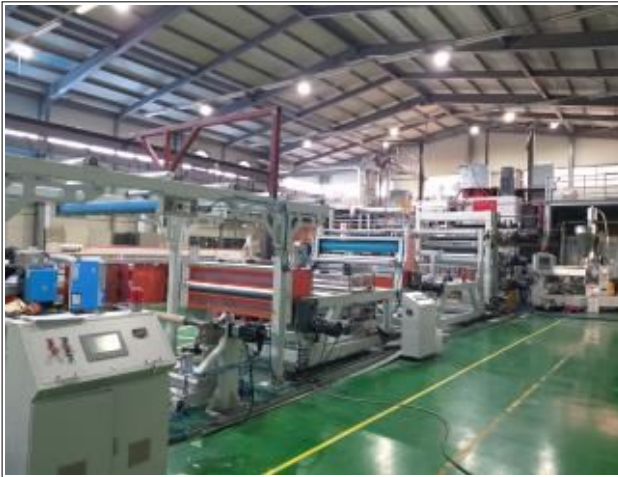
1. 2단 설비 전경
