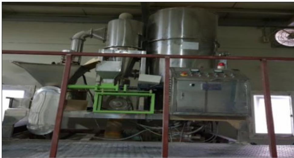
그림 5. 혼합 분체용 ACM 설비
