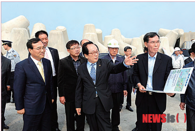
10일 전북 고창에서 '제9회 자율어업관리 전국대회'가 열렸다. 행사에 참석하기 위해 고창을 방문한 서규용 농림식품부 장관(앞줄 가운데)이 이강수 군수(왼쪽)를 비롯한 군 관계자들과 '구시포항 건설사업' 현장을 둘러보고 있다.
