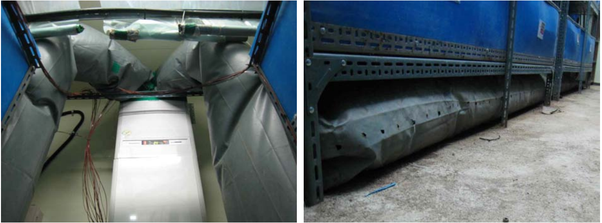
Photo. 2-2 유도 호수 설치 후 가동 상태
