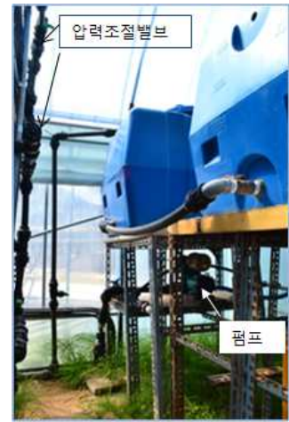
물통, 펌프, 압력조절밸브
