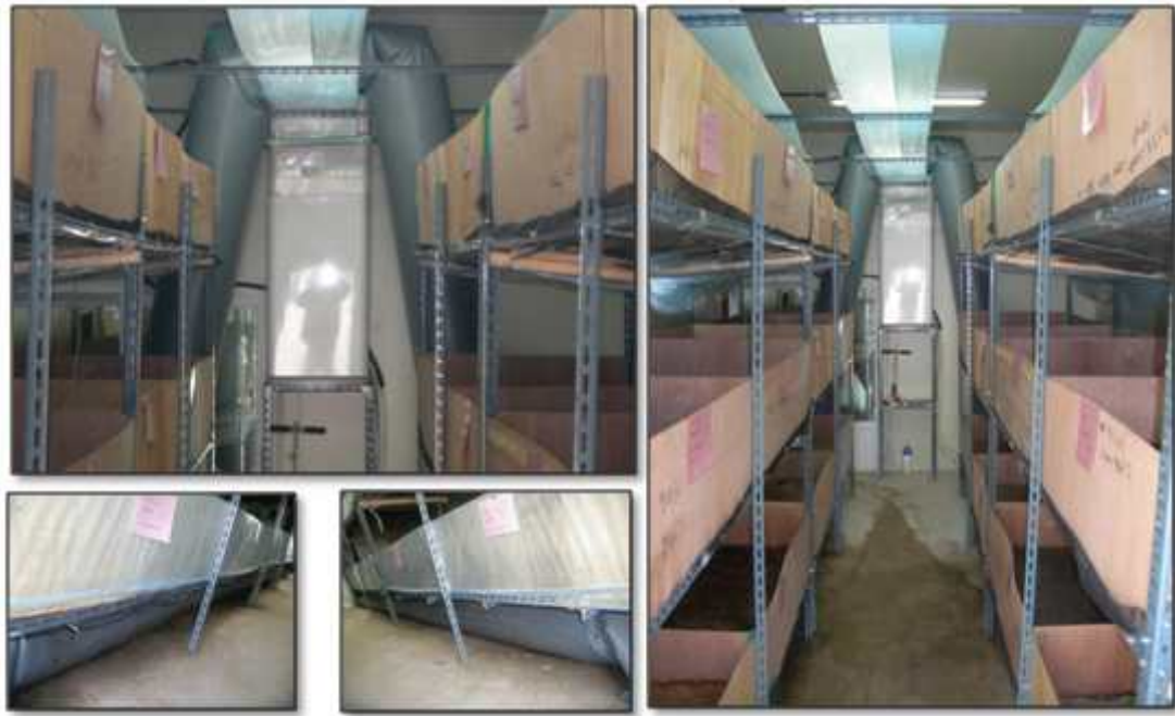
Photo. 3-2 B-Type의 난방시스템 “B동” 설치운영 상태
