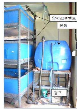
물통, 펌프, 압력조절밸브
