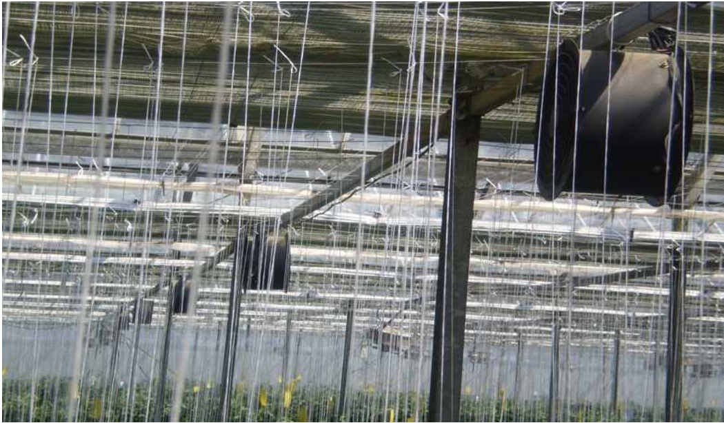
그림 9-1. 온실내 설치된 유동팬
