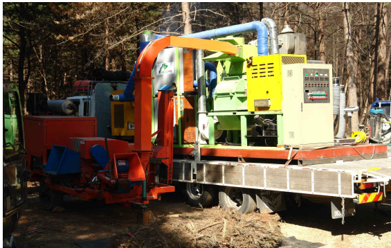
설치된 목재 파쇄기
