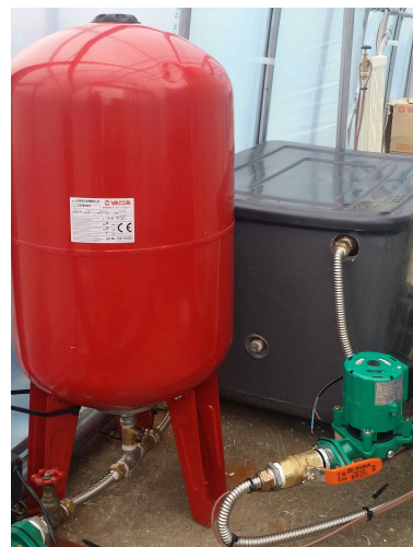
(b) 열매체 순환탱크와 연결된 질소압력탱크 [그림 3-6] 열매체 순환탱크
