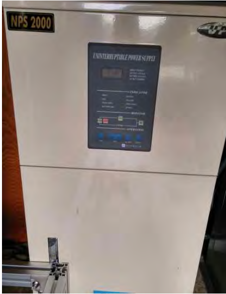
그림 3.12.59 무정전 전원장치 (UPS)
