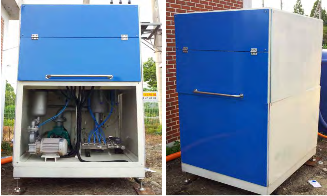
그림 5.1.4 중대용량 간접재이용시스템의 현장설치 전경
