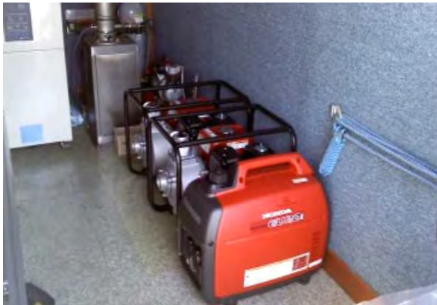
그림 3.12.61 엔진 펌프 및 엔진 발전기
