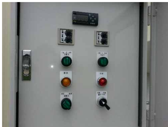
<제어시설-센서 및 타이머>
