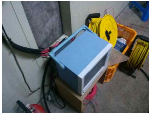
실내환경측정 데이터로거 설치
