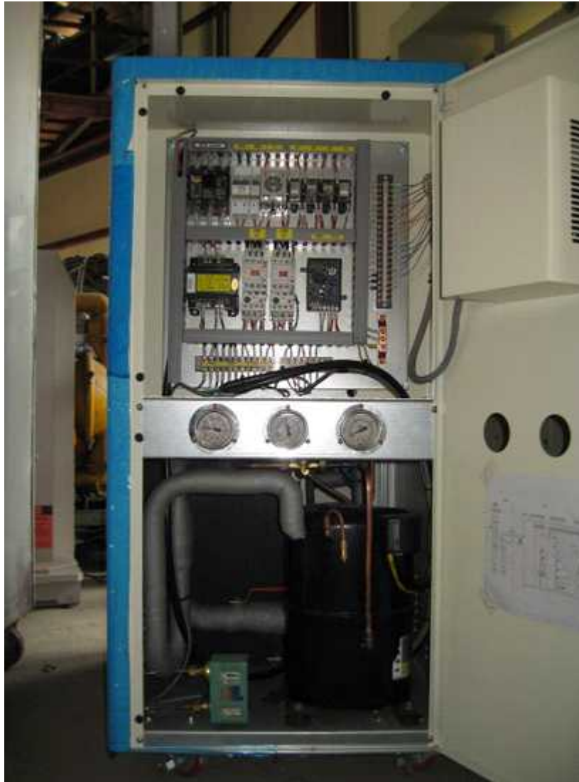
히트펌프 시스템 전경
