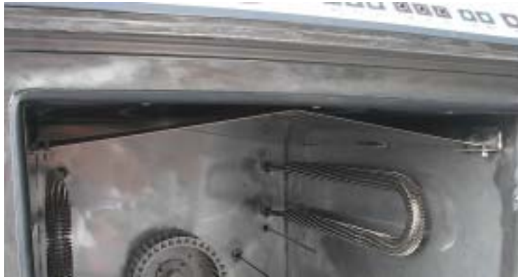
그림 3-4 챔버의 상단부에 설치된 경사관 물받이
