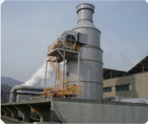
고흥군 가축분뇨 처리장
