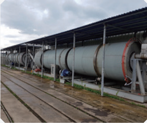
밀폐 수평 원통형 발효기 전경
