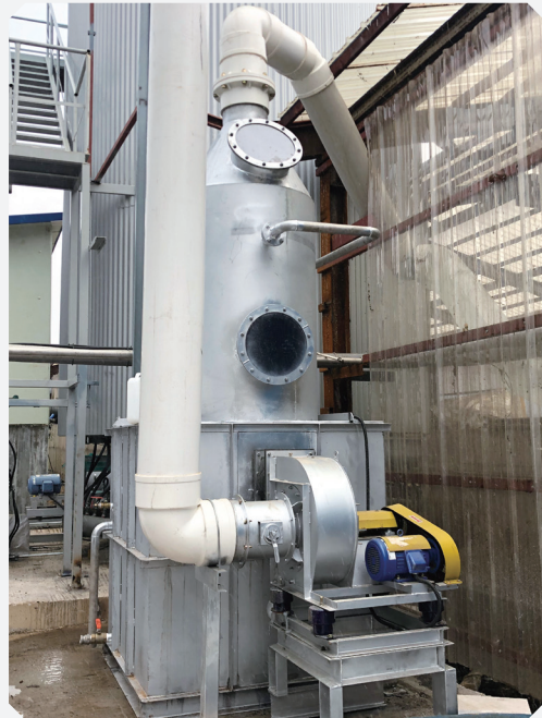
약취저감설비 설치 전경
