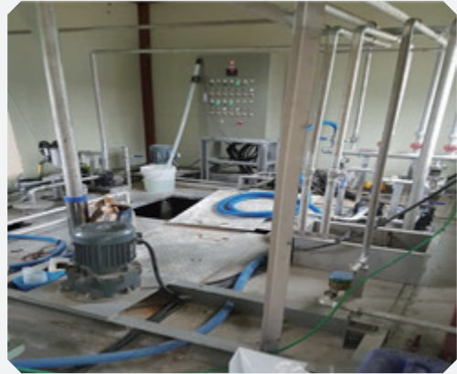
착유세척수 처리시설 내부전경
