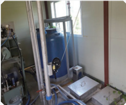
약품 반응 탱크 및 수중교반기 인양대
