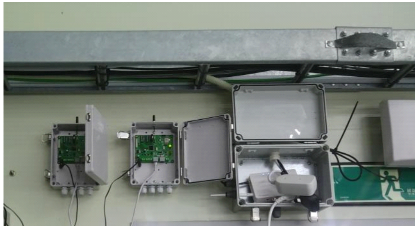
<식물공장 내 설치된 데이터 수집기>
