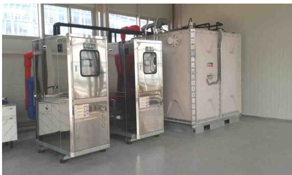
히트펌프(2대) 및 열원탱크
