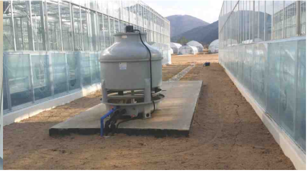
쿨링타워 및 지하 물탱크(20톤×2대)
