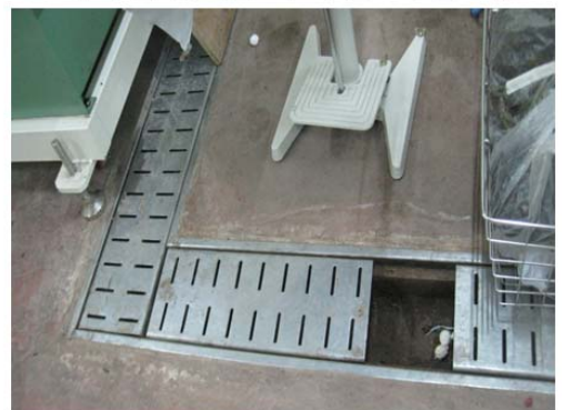
[배수시설 상태 불량]
