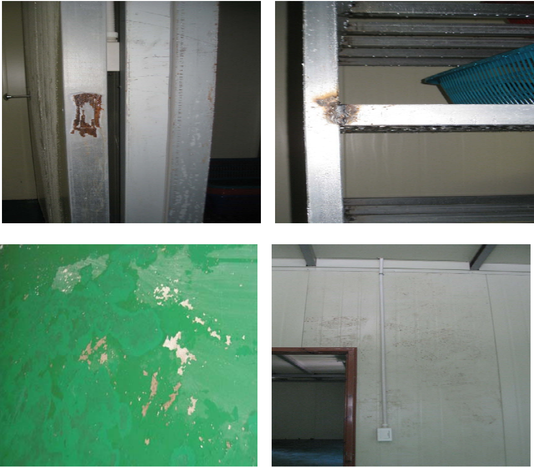
그림 7-19. 발효실의 높은 습도로 인한 공장 내부 위해요소 발생
