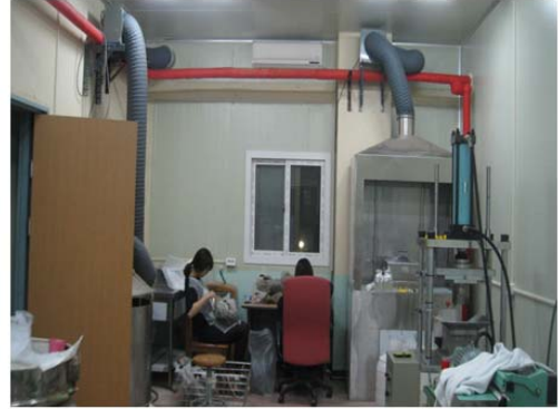
[작업장 환기시설 미설치]
