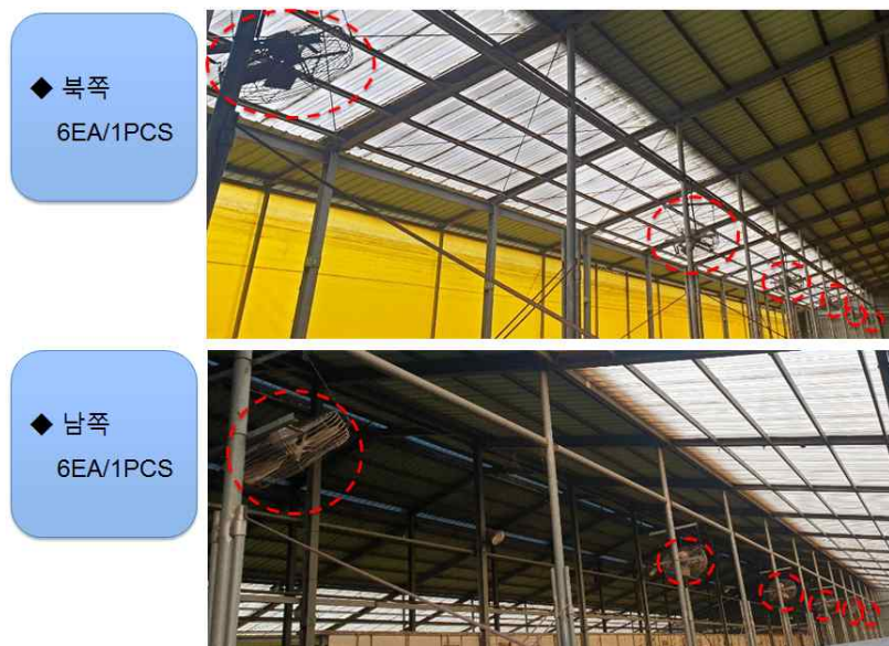
<ICT 연동 송풍기>
