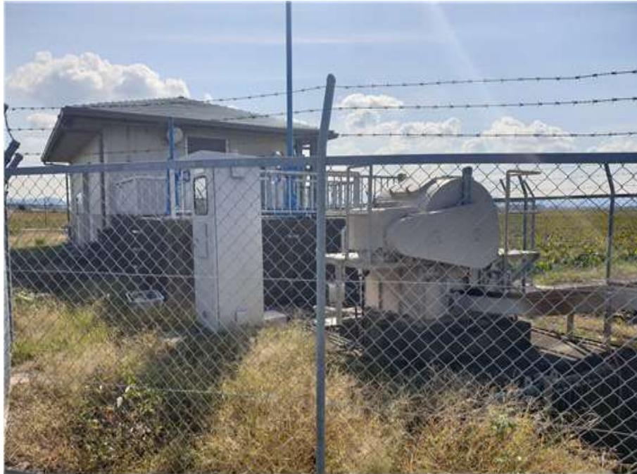
<시범지구 양수장 및 제진기 전경>
