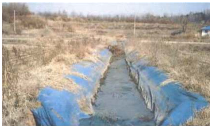
[그림 2-8-22] 비탈면이 붕괴된 토공수로 전경
