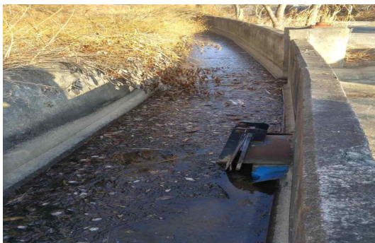
기설 내이양수장 송수관로 분기점(마홀저수지로 연결)
