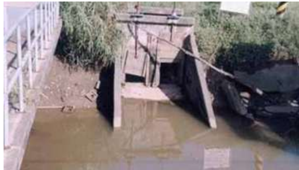
[그림 2-8-32] 파손된 수리 시설물 전경
