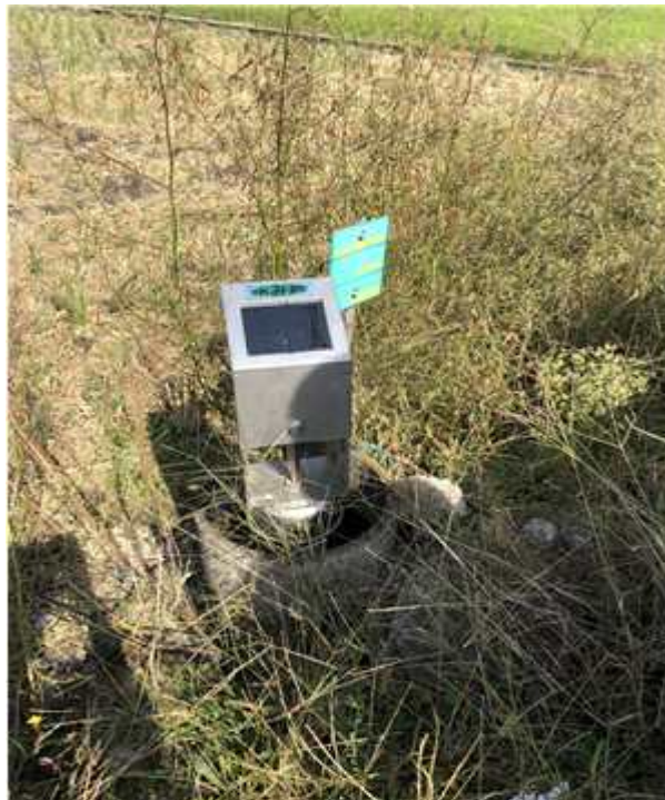
<시범지구 자동급수기 설치 전경>
