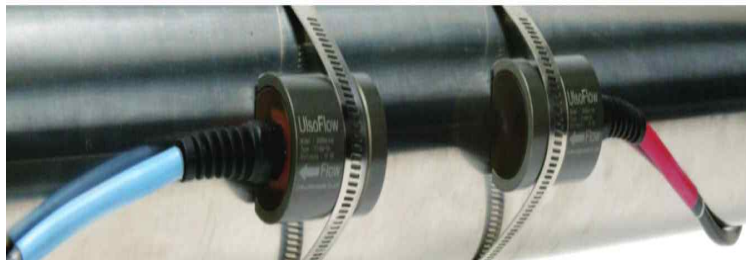
[그림 2-3-67] 대사지구 양수장 토출관로 설치 유량계
