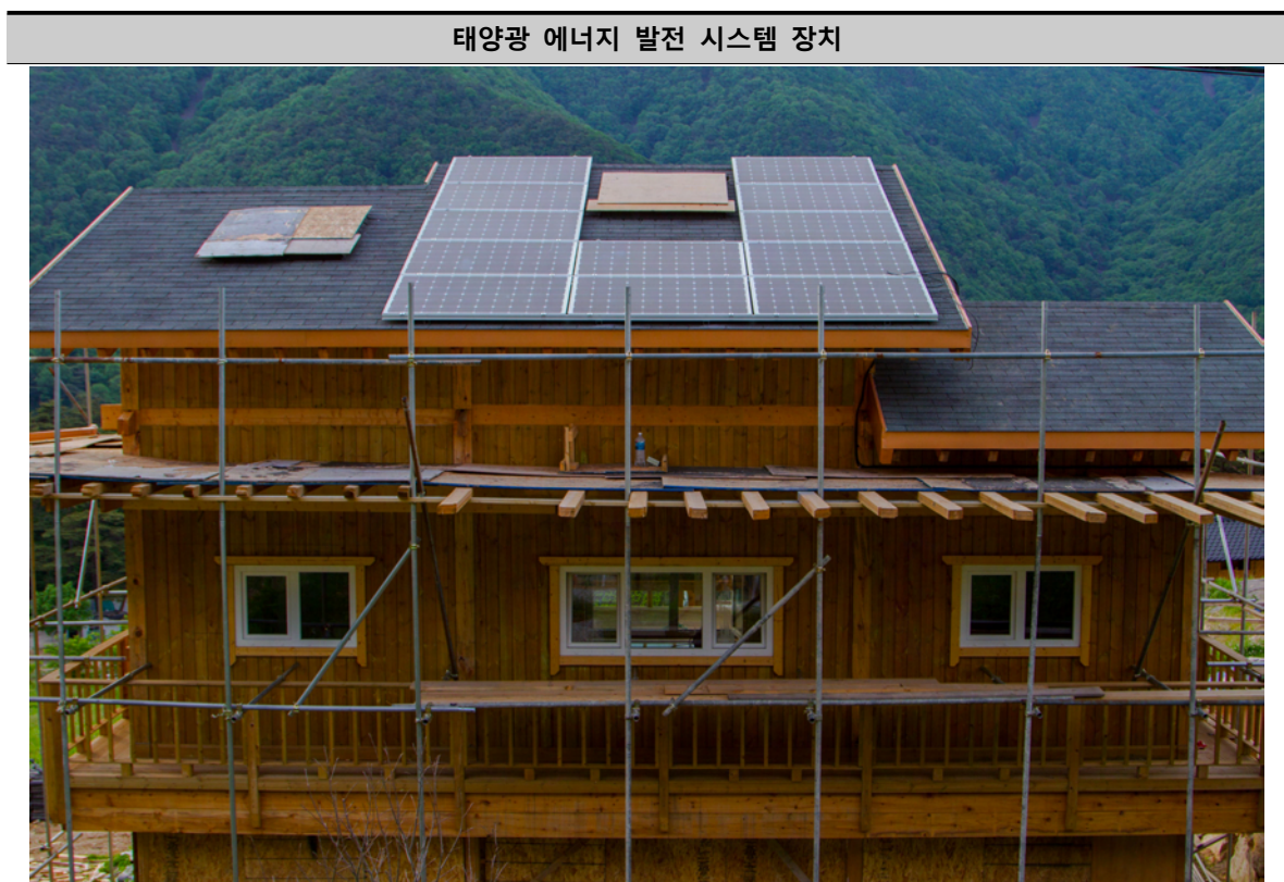
그림 65 Test-bed 태양광 발전 시스템 시공완료 사진
