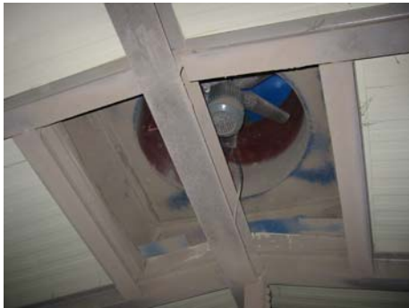
<천정에 설치된 상부 배기팬>
