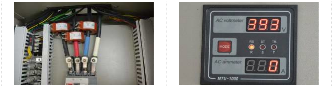
[부록 그림-31] 전원 인입부 및 전류센서
