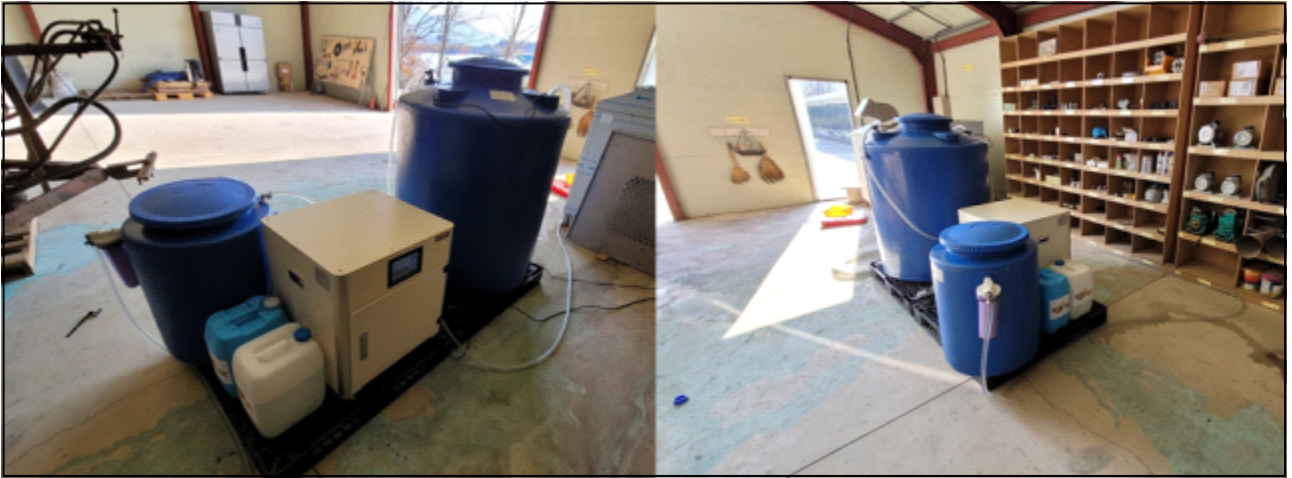
그림 2-1-31. ○○농장 소독수 생성장치 설치 사진
