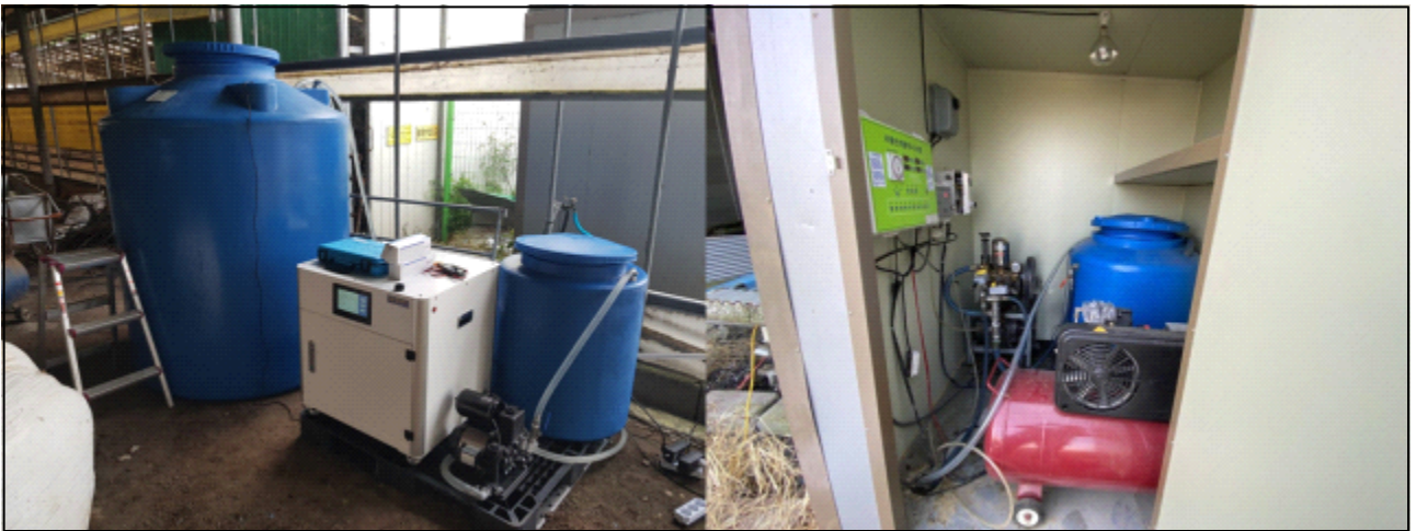
그림 2-1-37. 우사 소독수 생성장치 설치 사진
