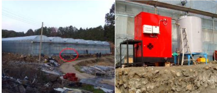
<그림 3-3> 펠릿 난방기 기계실 위치 및 설치 모습
